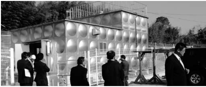
鎌手ポンプ場(山田上)
