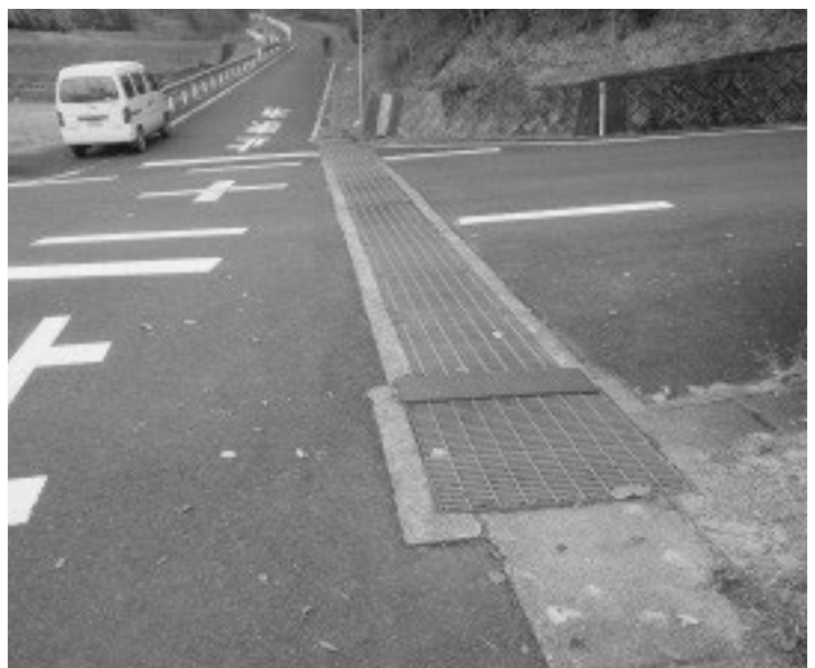
中讃南部大規模農道の老朽化した横断溝
