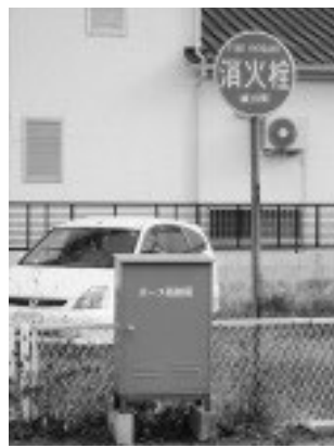
消火栓ボックス格納箱
