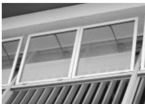
綾上中学校体育館の排煙窓
