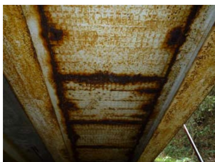
図 1.3 鋼橋の損傷状況
