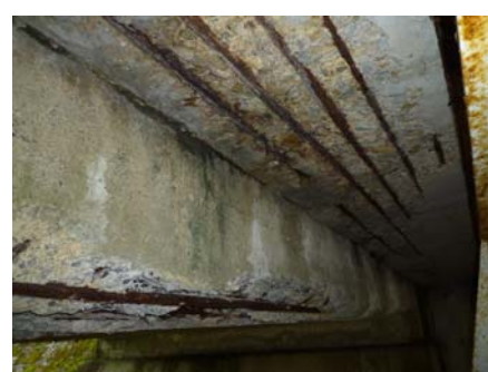
図 1.4 コンクリート橋の損傷状況
