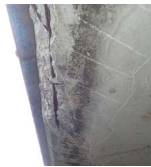
図 1.4 コンクリート橋の損傷状況
