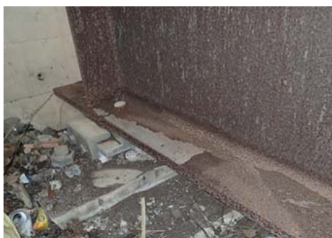
図 1.3 鋼橋の損傷状況
