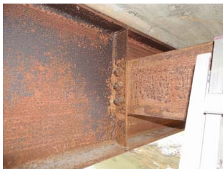
図 1.3 鋼橋の損傷状況
