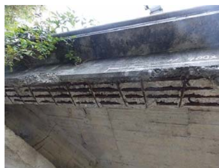
図 1.4 コンクリート橋の損傷状況
