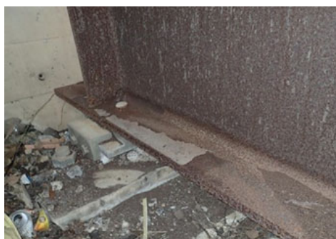
図 1.3 鋼橋の損傷状況
