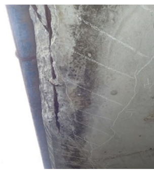
図 1.4 コンクリート橋の損傷状況
