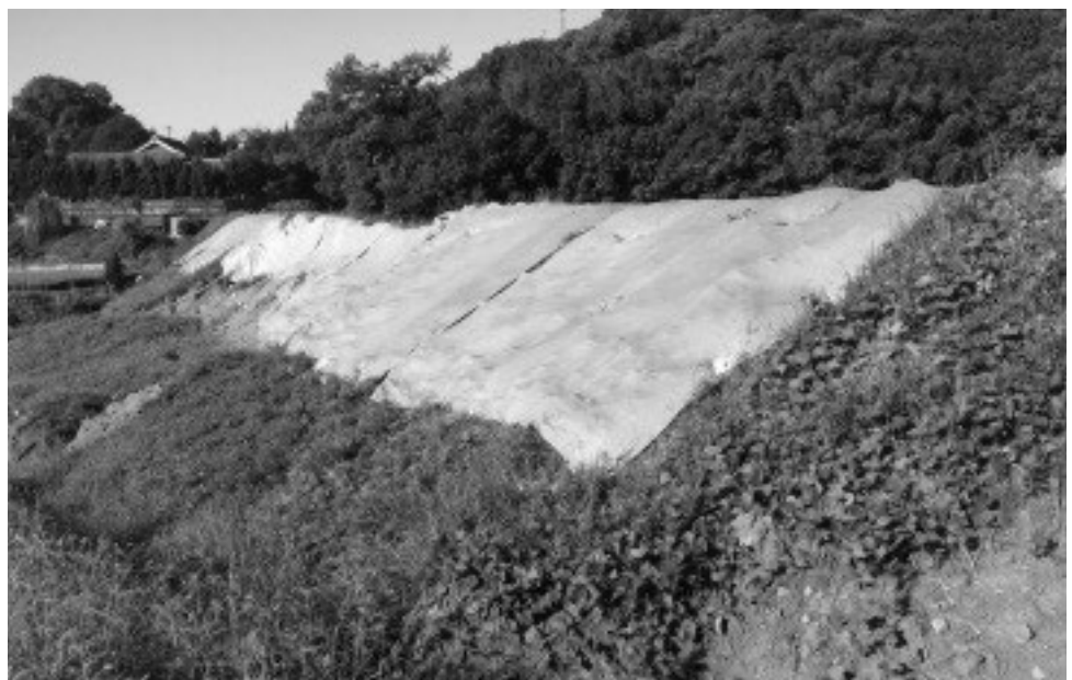
7月の西日本豪雨により被災した奥池の堤防（滝宮地区藤尾）
