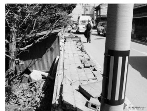
出典：消防防災科学センター （災害写真データベース）
