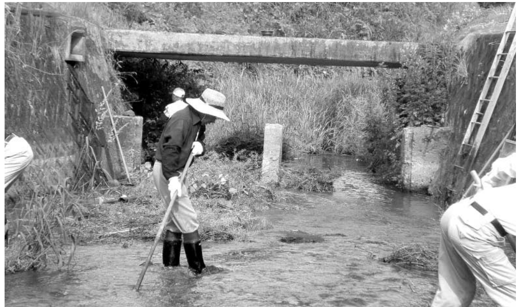
改修工事が望まれる富川
