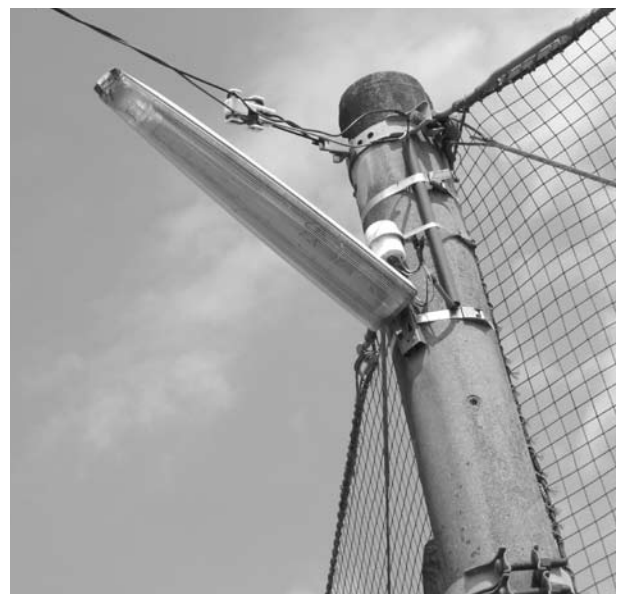
綾南中学校付近のLED街路灯
