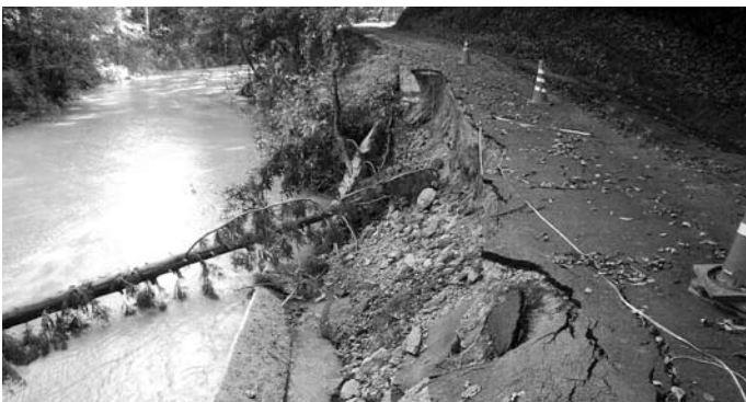
崩壊した町道(粉所西)
