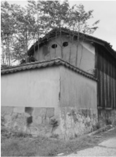
放置され廃屋となった空き家
