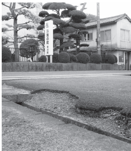
町道羽床屯所線の路肩欠損部分
