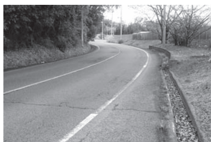
歩道が未整備の県道府中造田線
