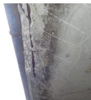
図 1.4 コンクリート橋の損傷状況
