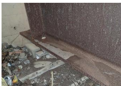
図 1.3 鋼橋の損傷状況
