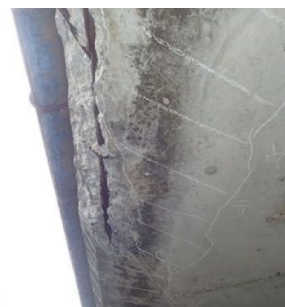
図 1.4 コンクリート橋の損傷状況
