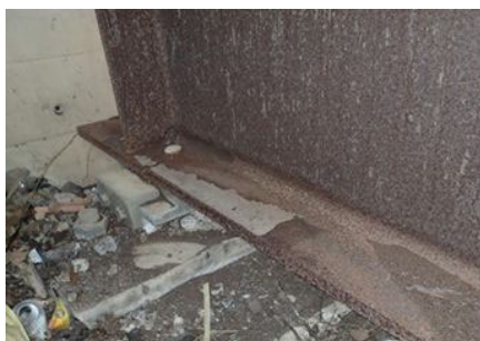
図 1.3 鋼橋の損傷状況
